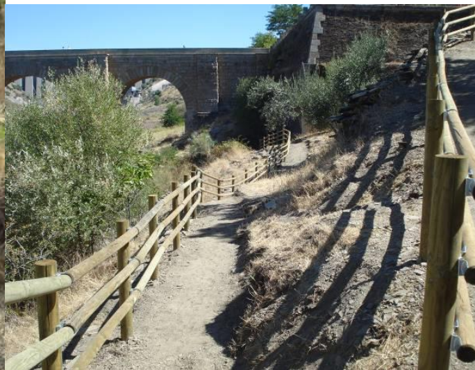
Construcción de una senda peatonal en el entorno del Puente Romano. T.M. de Alcántara (Cáceres). PROYECTO DE ACONDICIONAMIENTO DE CAUCES Y MEJORA DE SU ENTORNO EN LA PROVINCIA DE CÁCERES. CÁCERES NORTE II. COMARCAS DE TAJO-SALOR Y VEGAS DEL ALAGÓN FEDER 2007-2013
